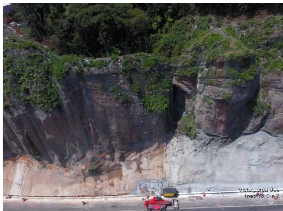
Face já finalizada dos taludes (fotografada por drone) em um dos trechos da Obra 744
