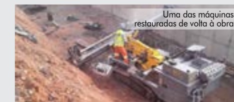
O novo espaço para as máquinas de grande porte
